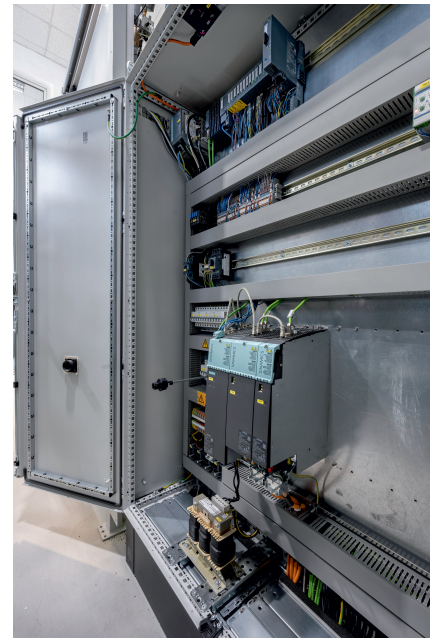
Bild 3. Schaltschrank mit modularelem Antriebsverband Sinamics S120 (unten) und Simatic S7-1500 Open Controller (oben): Neue Automatisierungstechnik spart mehr als die Hälfte des Platzes im (bisherigen) Schaltschrankfeld. © Siemens
